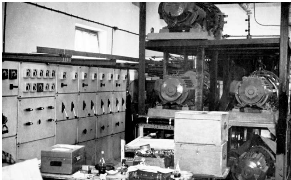
Пульт управления стендом по исследованию аварийных режимов при больших течах первого контура. Научно-исследовательская теплофизическая лаборатория, СВВМИУ
