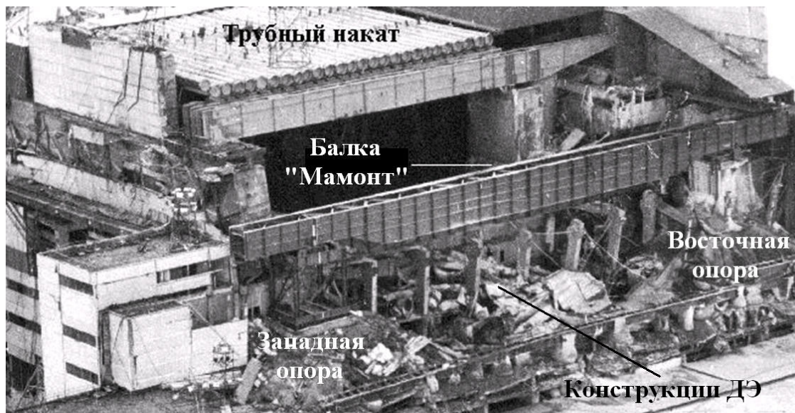
Рис.2. Балка «Мамонт» и ее опоры (в период строительства «Укрытия»). Разрушенные конструкции деаэрационной этажерки. Колонны отклонены в сторону машинного зала.
