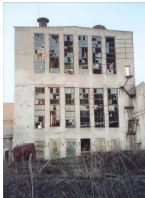
Полуразрушенное здание торфопредприятия
