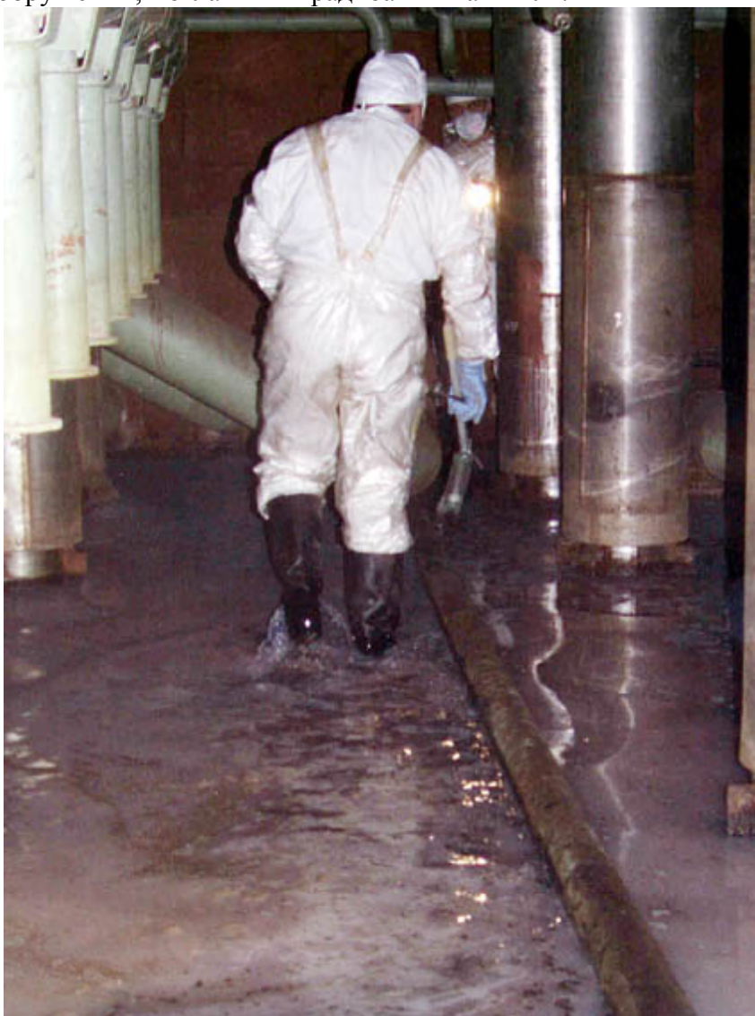
Рис. 32. Вода, проникшая на нижние отметки объекта «Укрытие»
