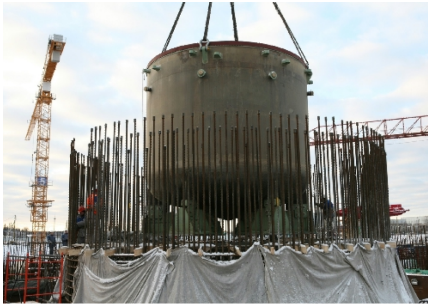
Рис. 29. На Ленинградской АЭС-2 начался монтаж устройства локализации расплава. В подготовленную шахту был установлен 160-тонный корпус ловушки (2009г.).
