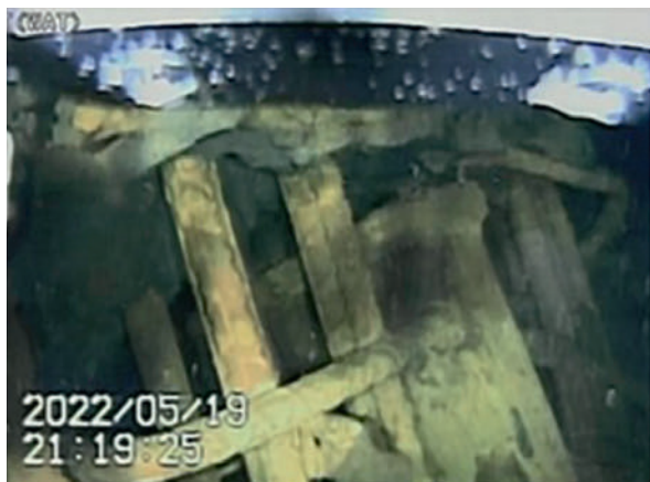
Рис. 32. Открытая стальная арматура (справа от двери)
