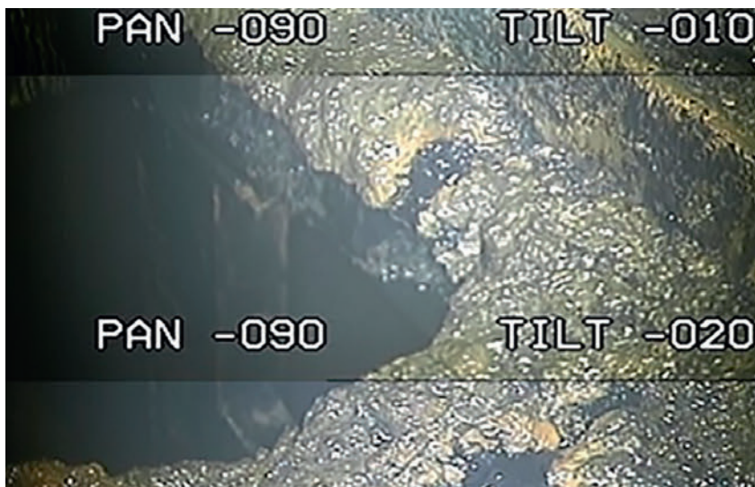
Рис. 10. Провал от упавшей части опорной решётки, обнаруженный 30.01.17
